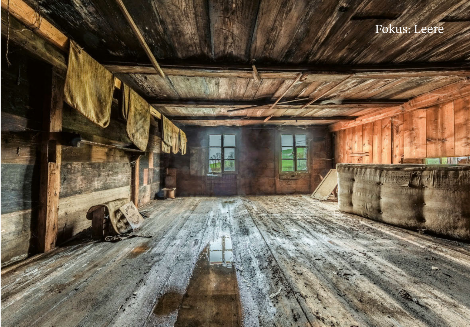
Die ehemalige Mühle mit Baujahr 1574 wurde 1864 umgebaut, seit 1921 ist der Mühlebetrieb eingestellt. Das eigentliche Wohnhaus ist seit über 30 Jahren unbewohnt. Bei einem Hagelsturm im Jahr 2021 wurde das Dach stark beschädigt.
